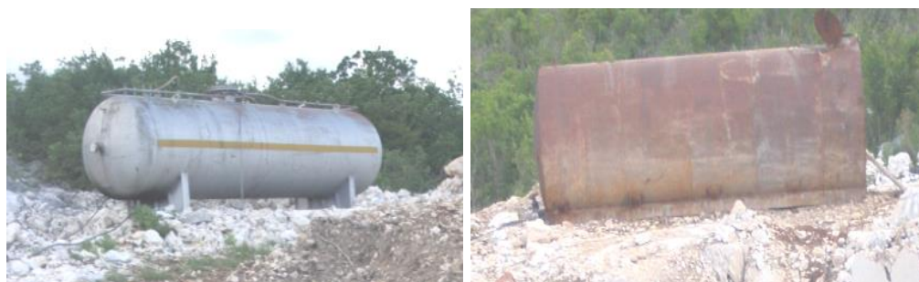
Слика бр. 20. Резервоари за воду
