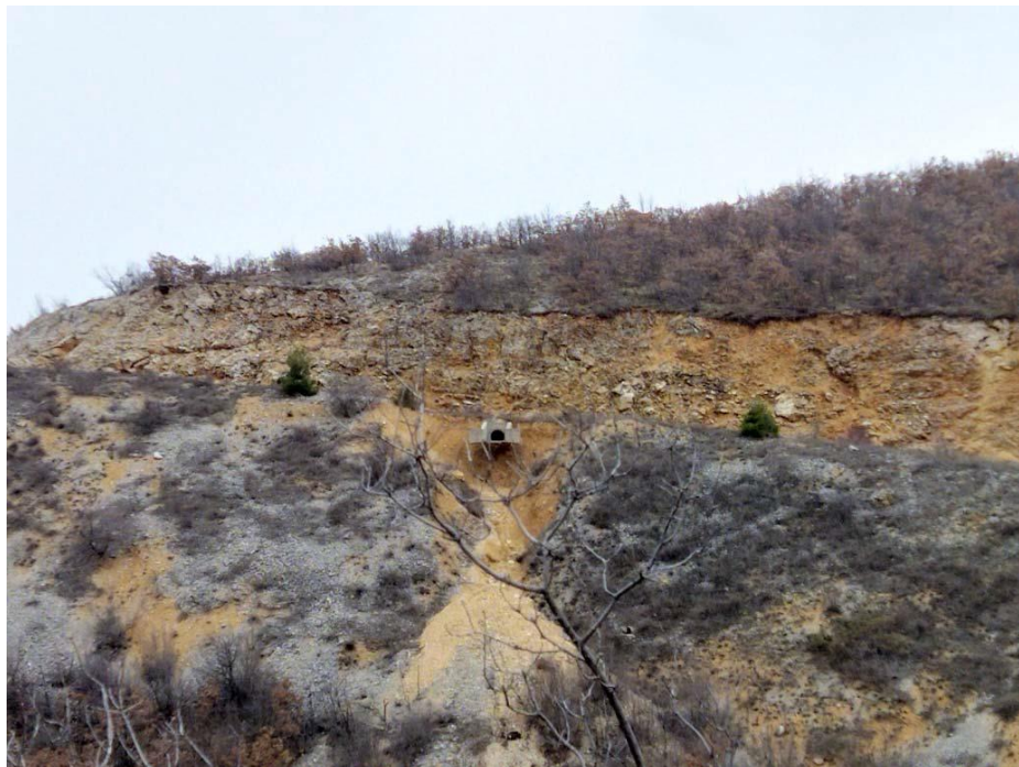
Slika 66 Pogled prema stupu 49 i vidljivi trošni dolomiti u zasjeku prometnice
