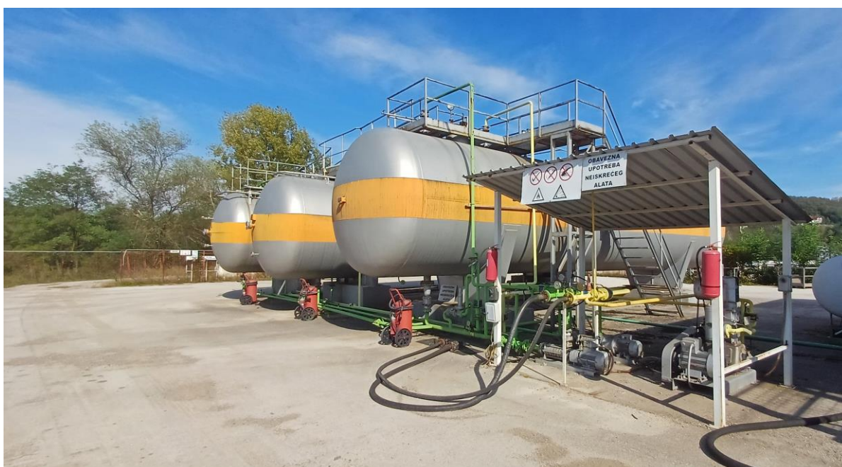
Slika 2 Pogled na spremnike UNP-a i opremu za pretakanje
