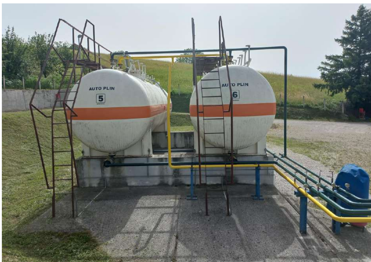
Slika 9. Spremnici UNP-a propan-butan smjesa
