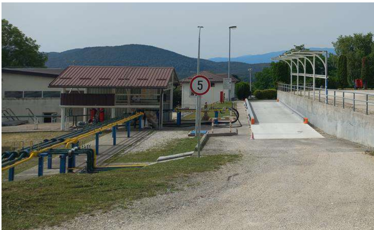
Slika 10. Pretakalište i pumpno-kompresorska stanica
