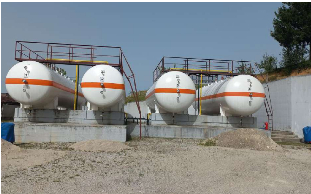
Slika 8. Spremnici UNP-a propan-butan smjesa
