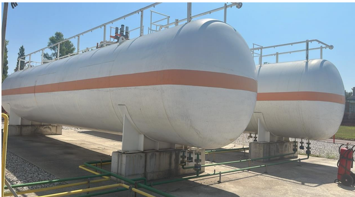
Slika 9 Prikaz izvedbe cjevovoda pokraj spremnika UNP-a te sistema za hlađenje rezervoara
