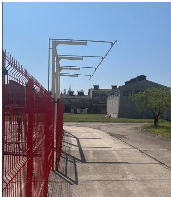
Slika 10 Prikaz sustava za hlađenje na pretakalištu autocisterni
