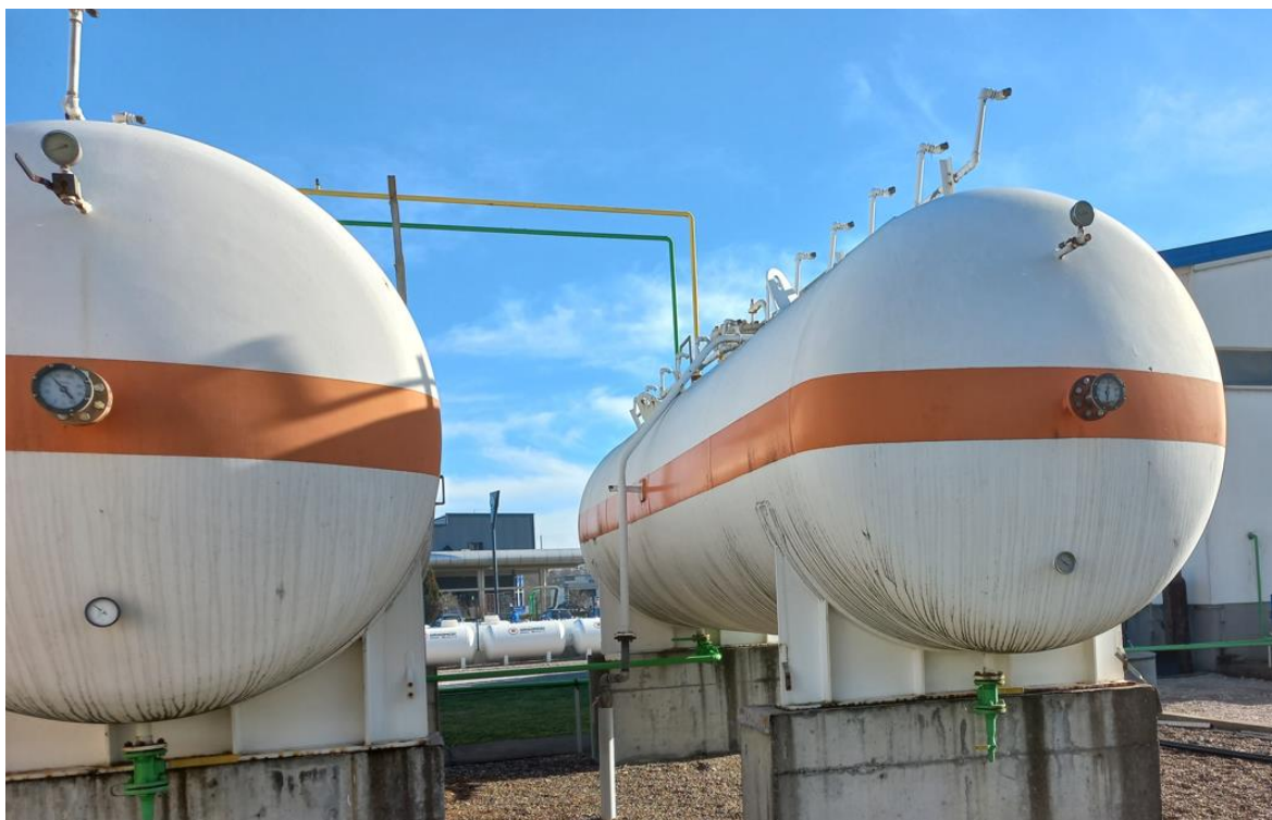
Slika 23. Mjerno-regulaciona oprema, sistem za hlađenje rezervoara
