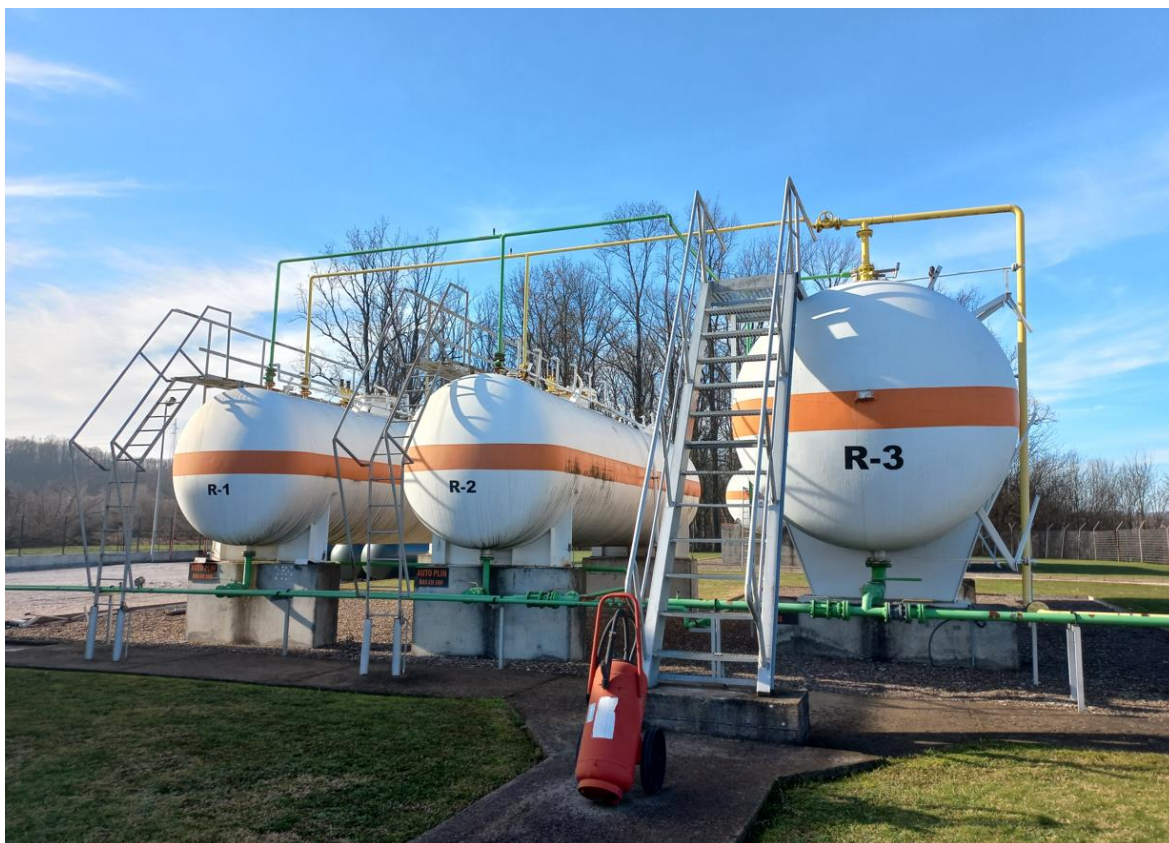
Slika 13. Nadzemni rezervoari za skladištenje UNP-a R-1, R-2 i R-3
