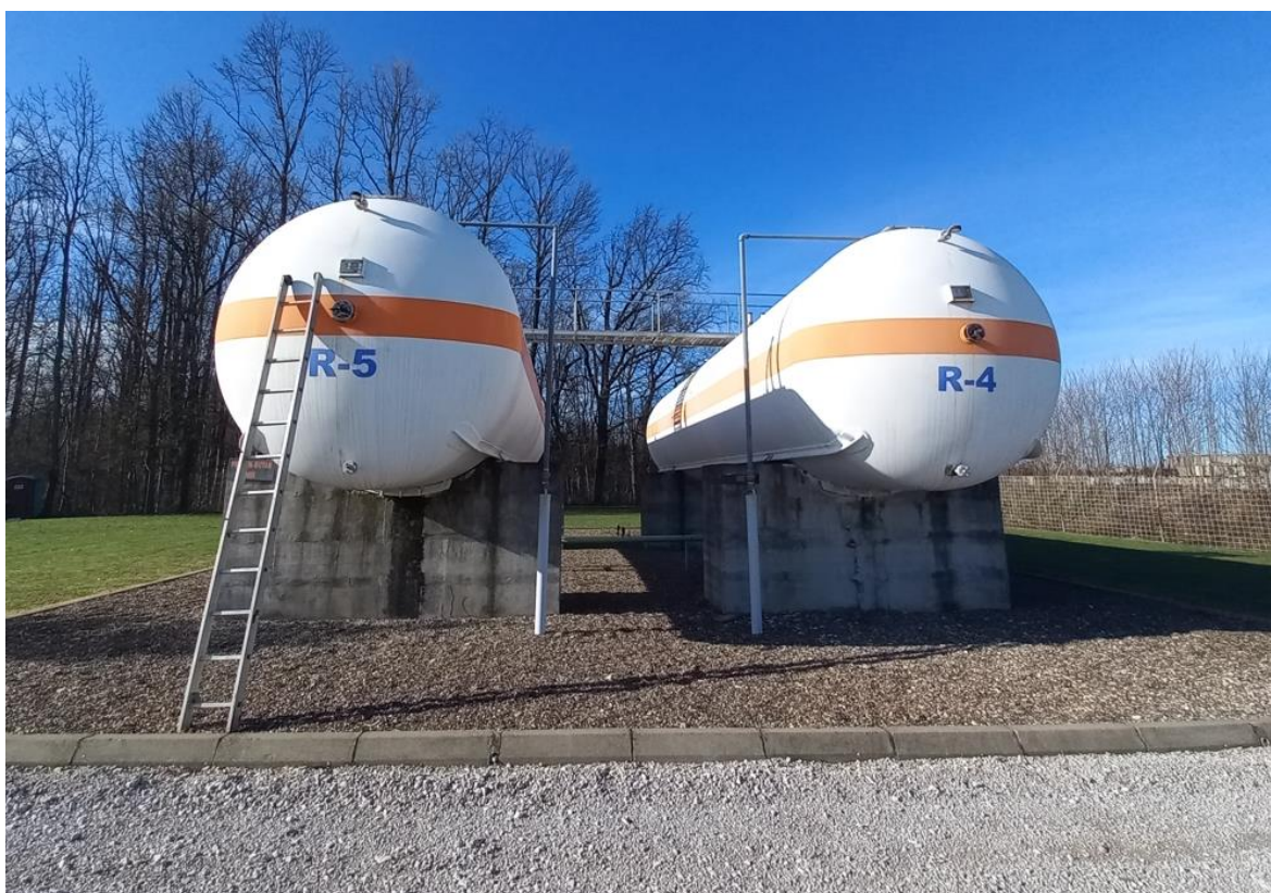
Slika 14. Nadzemni rezervoari za skladištenje UNP-a R-4 i R-5
