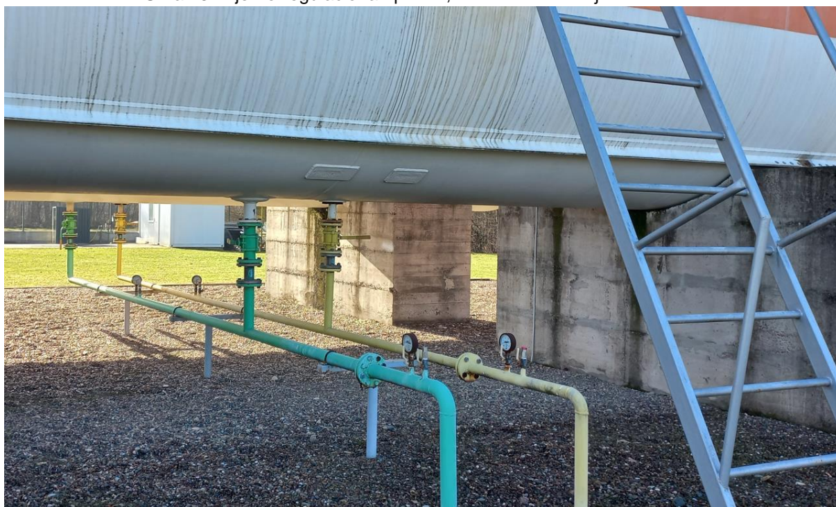
Slika 24. Mjerno-regulaciona oprema, gromobranska instalacija
