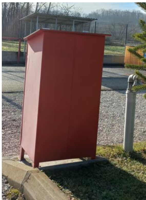
Slika 20. Vanjska hidrantska mreža
