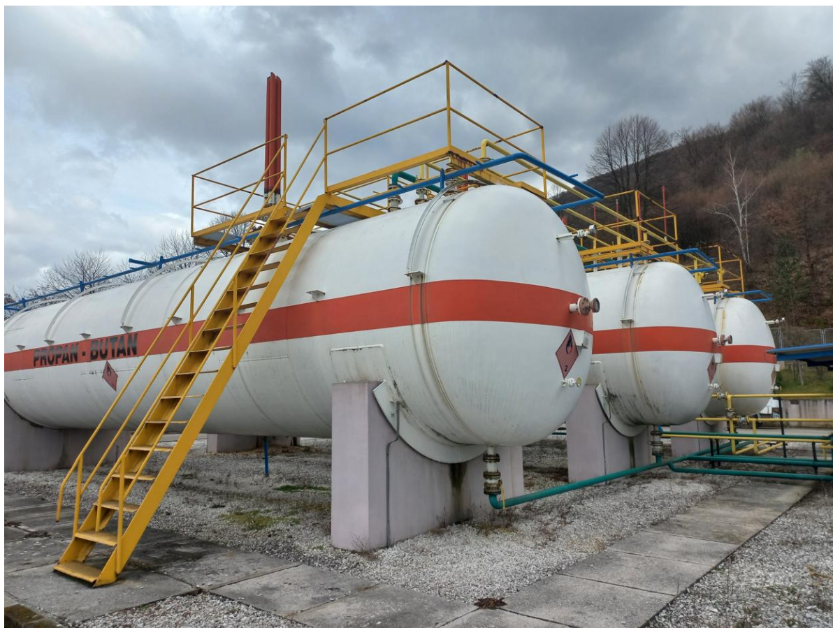
Slika 10. Spremnici za skladištenje UNP-a
