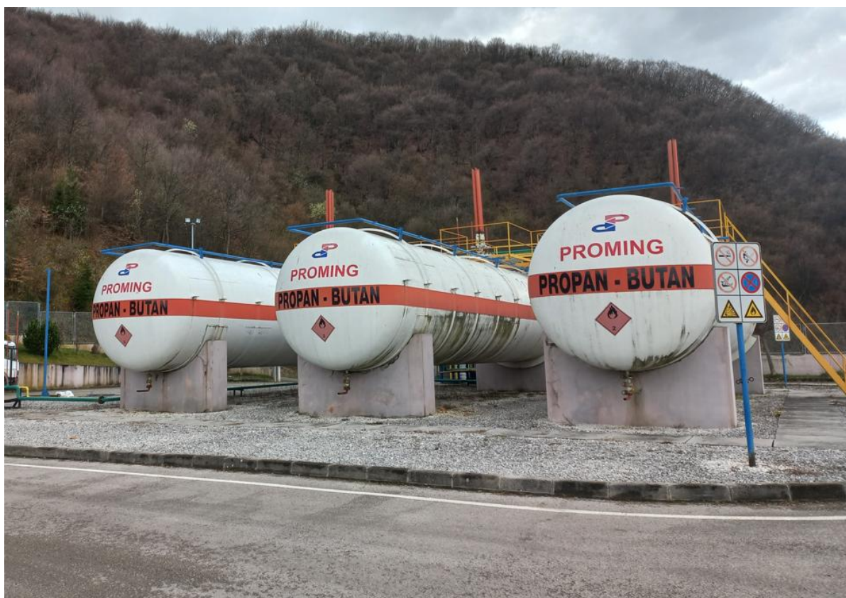
Slika 9. Spremnici za skladištenje UNP-a
