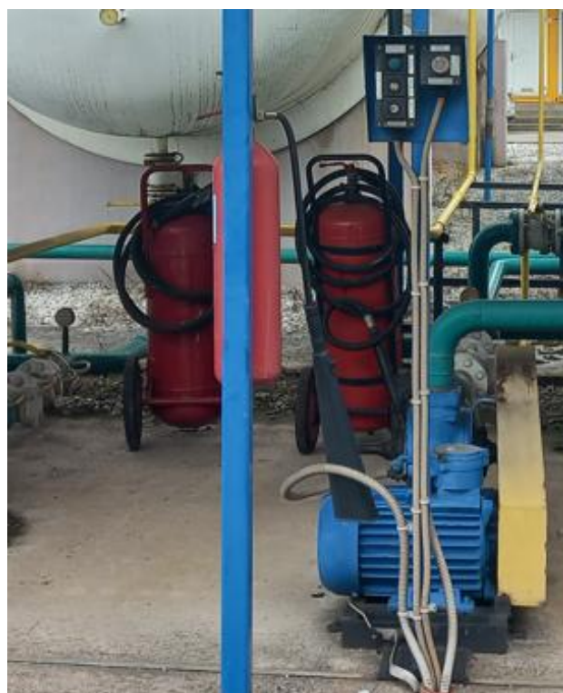
Slika 16. Aparati za početno gašenje požara
