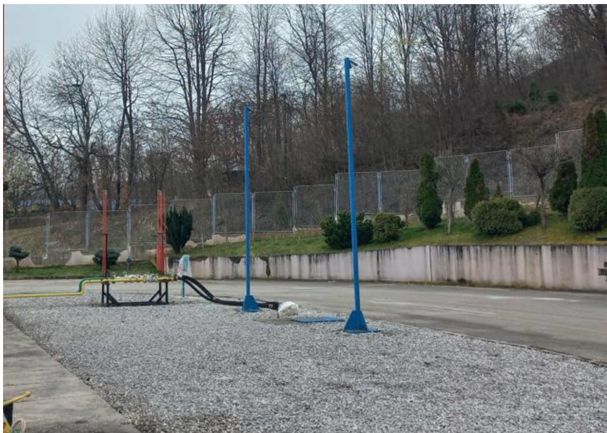
Slika 11. Pretakalište UNP-a sa sistemom za hlađenje
