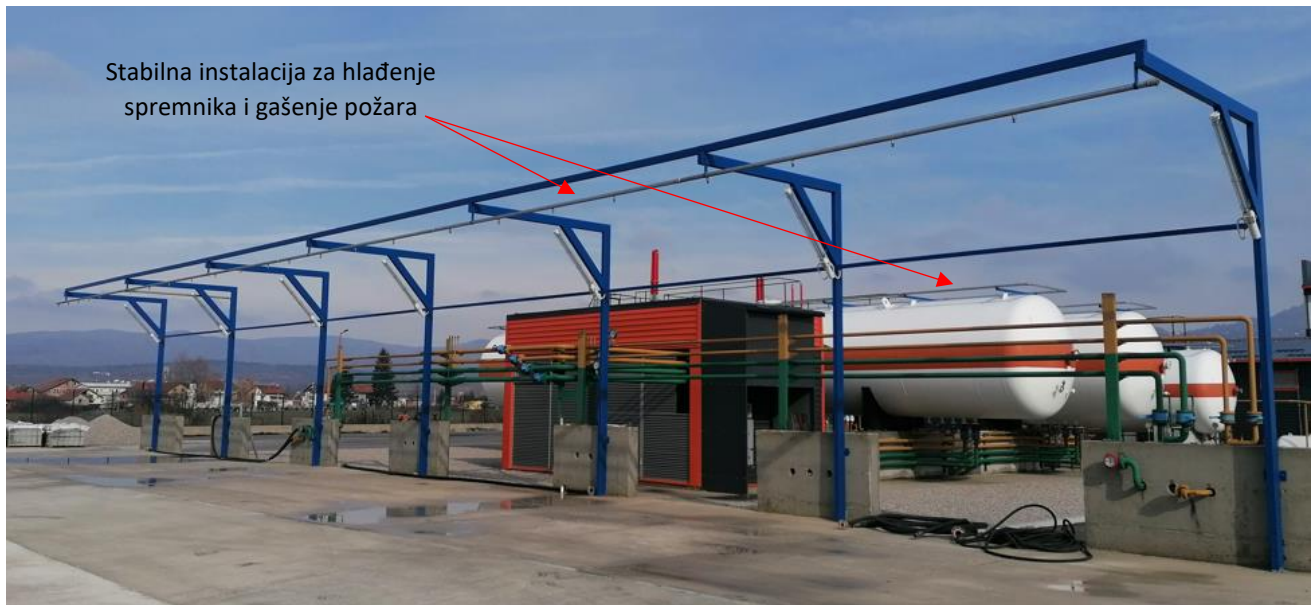
SLIKA 45: PRIKAZ STABILNE INSTALACIJE ZA HLAĐENJE SPREMNIKA I GAŠENJE POŽARA
