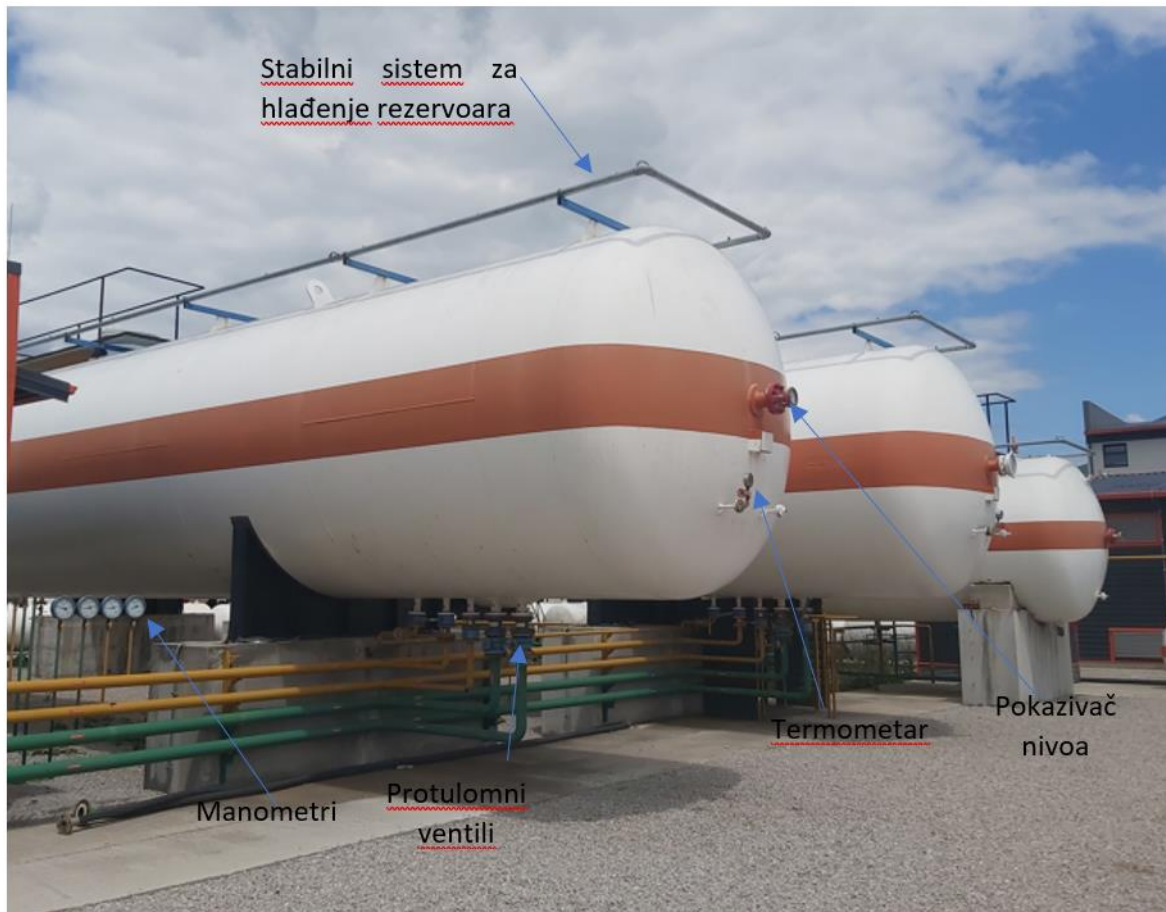
SLIKA 3: OPREMA KOJA OMOGUĆAVA PRAĆENJE RADNIH PROCESA I RANO PREPOZNAVANJE POREMEĆAJA U SISTEMU SA PRIKAZOM STABILNOG SISTEMA ZA HLAĐENJE REZERVOARA
