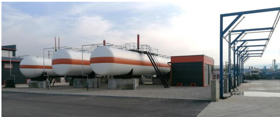
SLIKA 18: NADZEMNI REZERVOARI UNP-A, PRETAKALIŠTE I PUMPNO-KOMPRESORSKA STANICA
