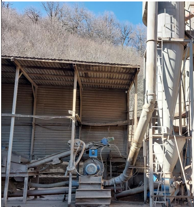
Mlin za usitnjavanje biomase i transportni cjevovod sa ciklonom za odvajanje zraka od piljevine u sistemu drobljenja, separisanja i transporta biomase
