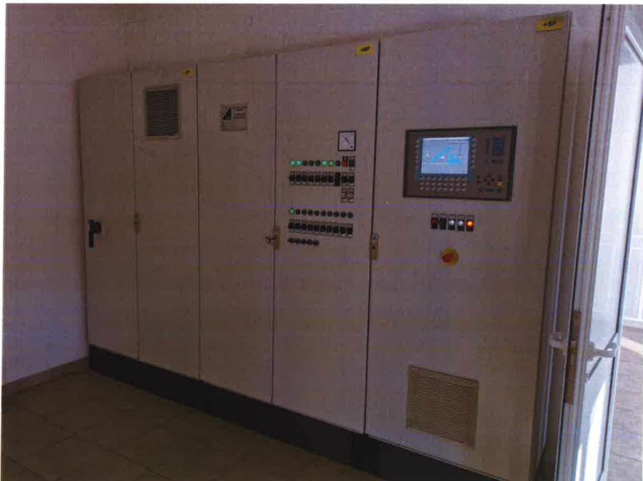
Slika 23 Upravljački ormar – automatsko upravljanje
