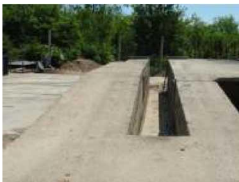
Slika 4.18. Kanal za sitne popravke i izmjenu ulja vozila
