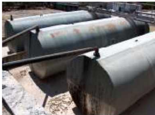
Slika 4.11 Spremnici bitumena u betonskom koritu
