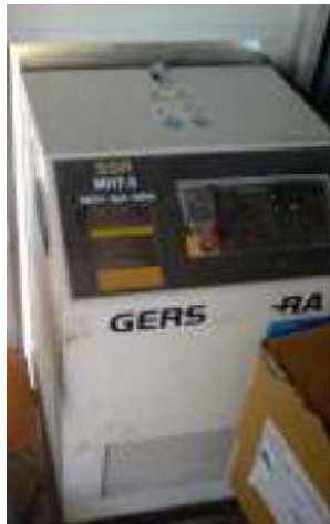
Slika 4.7. Izgled filtarskog postrojenja i slika 4.8. Vijčani kompresor
