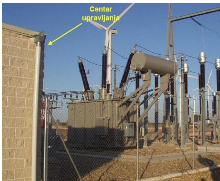
Slika 8. Mogući izgled transformatorskog postrojenja
