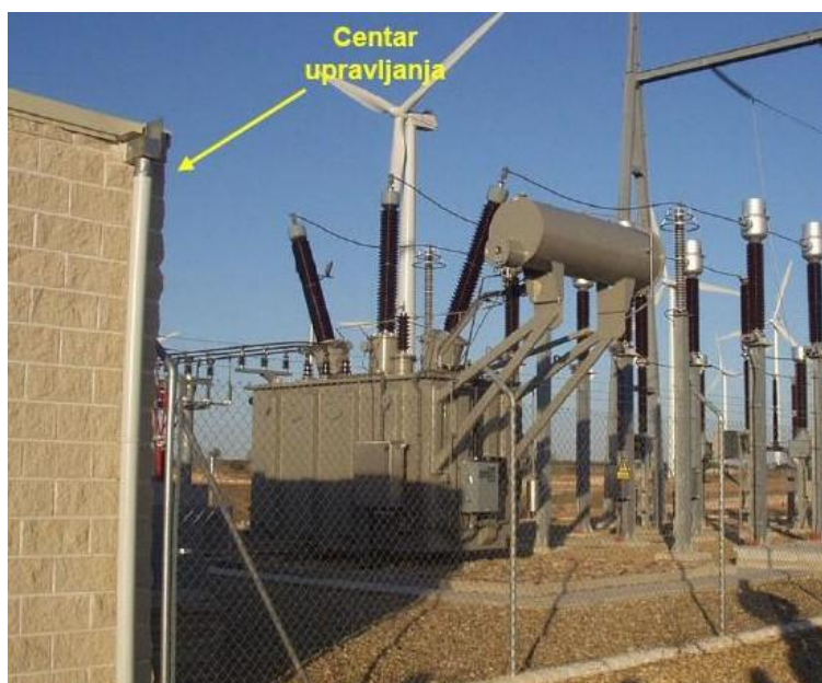
Slika 8. Mogući izgled transformatorskog postrojenja
