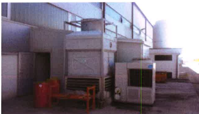
Slika 5 Objekt za zatvoreni sustav recikliranja i hlađenja tehnološke vode
